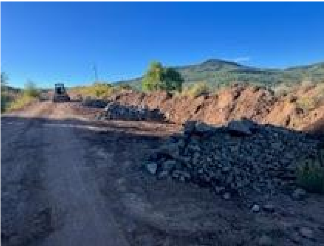
rock dam 3.jpg 23K
