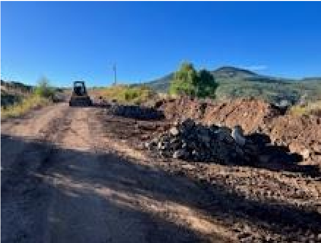
rock dam 4.jpg 26K
