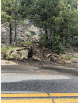
Collapsed Adit Damage.jpg 3528K
