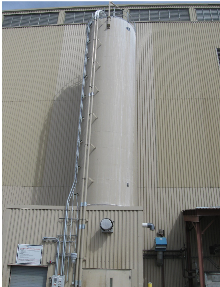
12. Lime Slaker silo.
